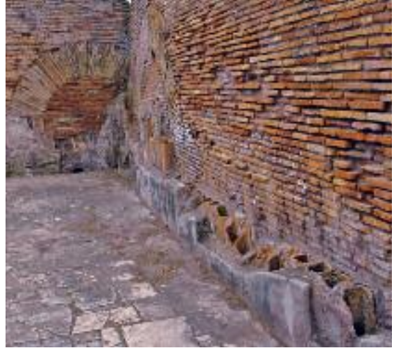
I mattoni forati utilizzati come tubi per il vapore
